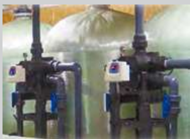
Станция обезжелезивания и деманганции воды хозяйственно-питьевого назначения производительностью 1000 м 3 /сутки
