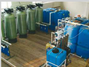
Станция получения сверхчистой воды для научно-производственного предприятия по изготовлению печатных плат
