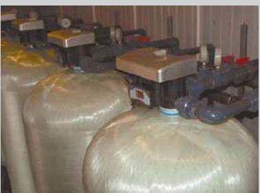
Станция обезжелезивания и обеззараживания воды производительностью 800 м 3 /сутки для детского оздоровительного лагеря
